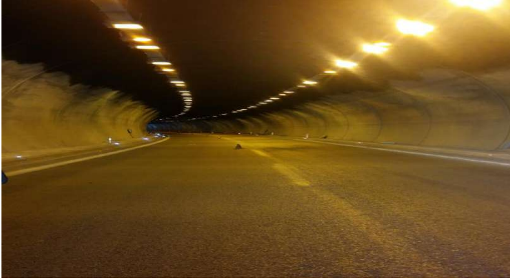
Şekil 4. T4 ( Buzlu Pınar Tüneli) HPS Armatür İle Aydınlatılması [2]
